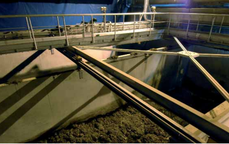
Centre de valorisation énergétique de Sequedin // The Sequedin waste-to-energy plant // Centrum voor energieherwinning van Sequedin
